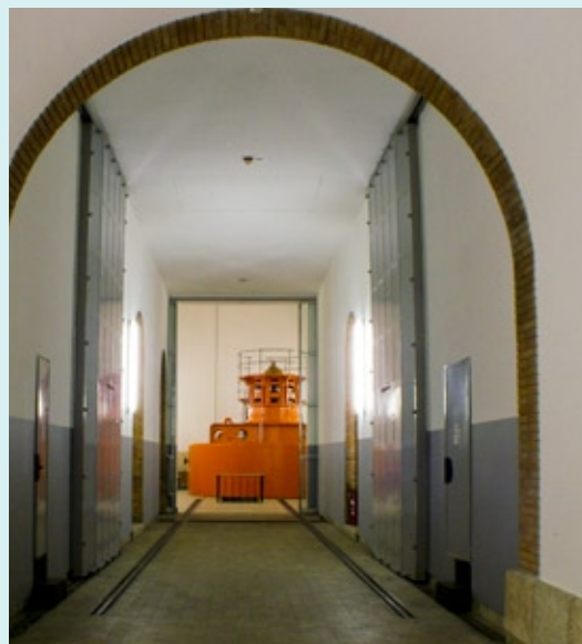
Pogled v strojnico elektrarne Plave
