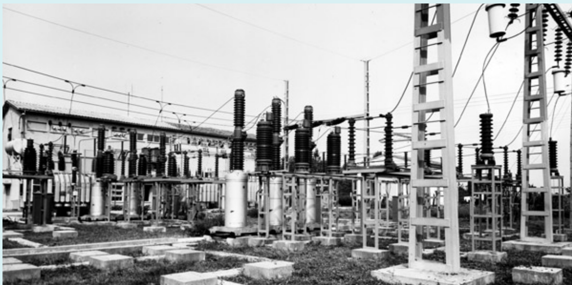
Razdelilna transformatorska postaja Koper okrog leta 1976
