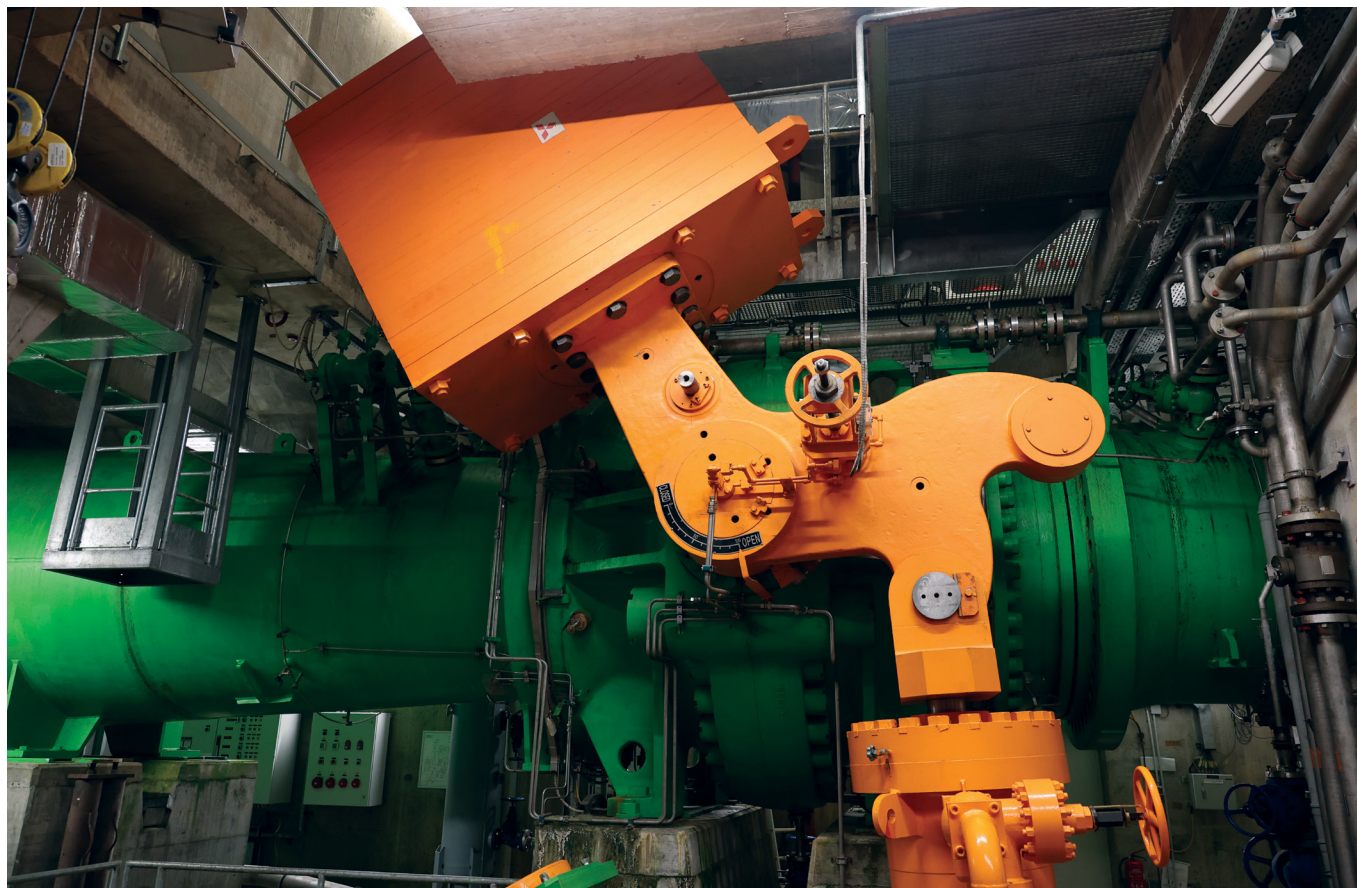
Dovodna cev in glavni ventil ČHE Avče.
