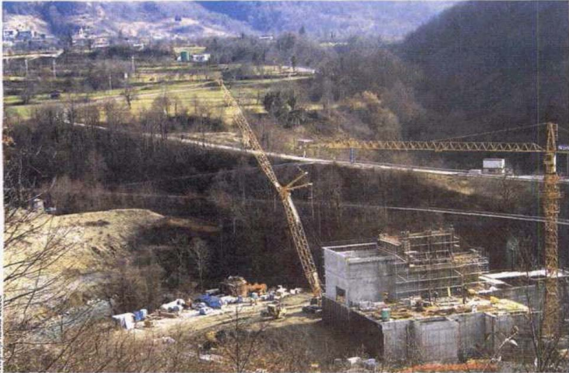
Črpalno hidroelektrarno v Avčah bodo v omrežje priključili v drugi četrtini prihodnjega leta. Zdaj okoli 80 metrov globokega strojniškega jaška gradijo strojno stavbo (na sliki).
