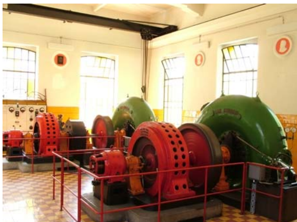
Slika 9: Notranjost strojnične zgradbe
