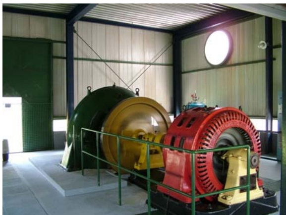
Slika 1: Notranjost strojnične zgradbe
