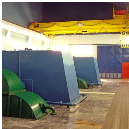
Slika 2: Notranjost strojnične zgradbe
