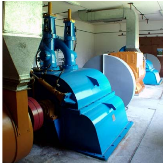
Slika 2: Notranjost strojnične zgradbe
