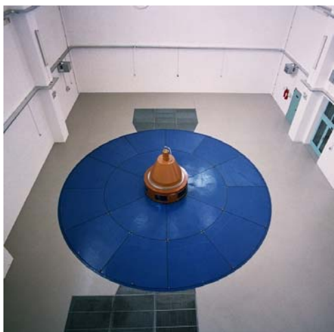
Slika 2: Notranjost strojnične zgradbe
