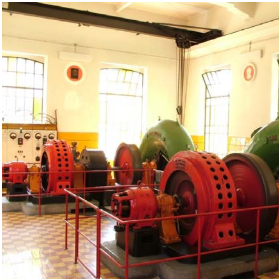
Slika 3: Notranjost strojnične zgradbe
