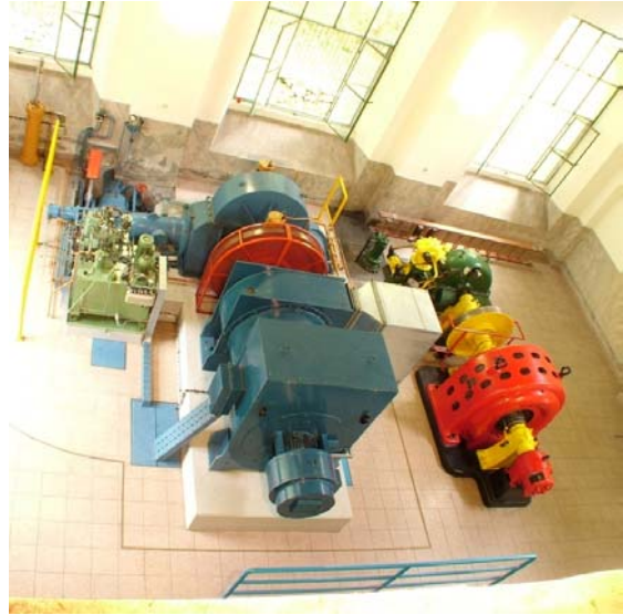
Slika 2: Notranjost strojnične zgradbe
