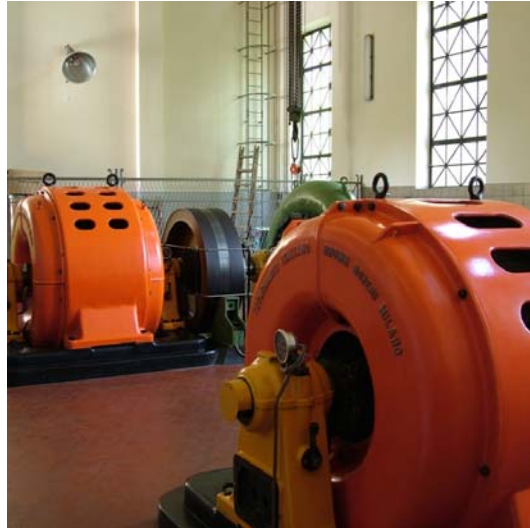
Slika 2: Notranjost strojnične zgradbe
