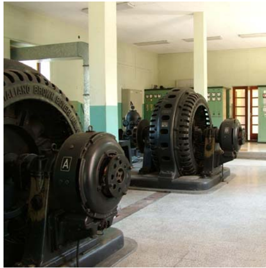
Slika 2: Notranjost strojnične zgradbe
