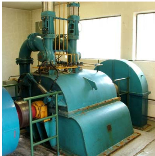
Slika 2: Notranjost strojnične zgradbe
