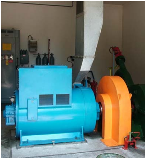
Slika 3: Notranjost strojnične zgradbe
